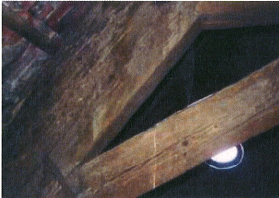
Obr. S53 – Deštruovaná horná časť ležiacej stoly
