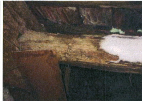
Obr. S58 - Detail poškodenia styku stĺpika a vážnice
