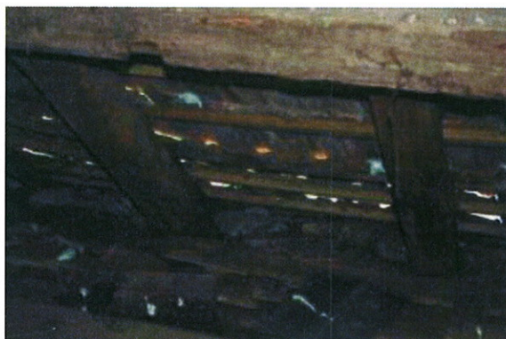
Obr. S49 – Zatečený krov cez poškodenú krytinu
