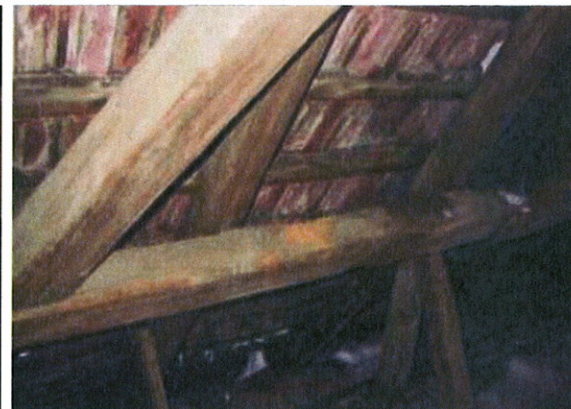
Obr. S56 – Biotické poškodenie vážnice
